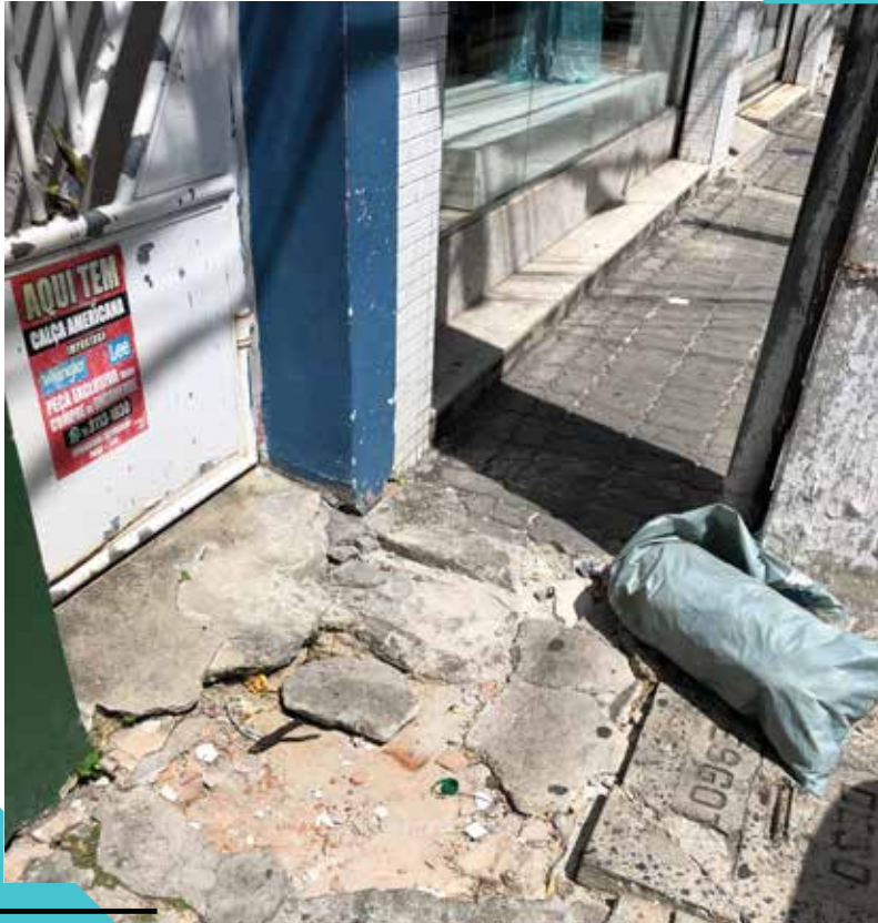
Fotografia de calçada com desníveis e entulho
